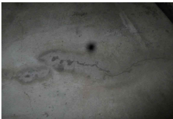
사진번호 095 위치 바닥 내 용 균열, 누수흔적 (A=0.1m×3.0m)
