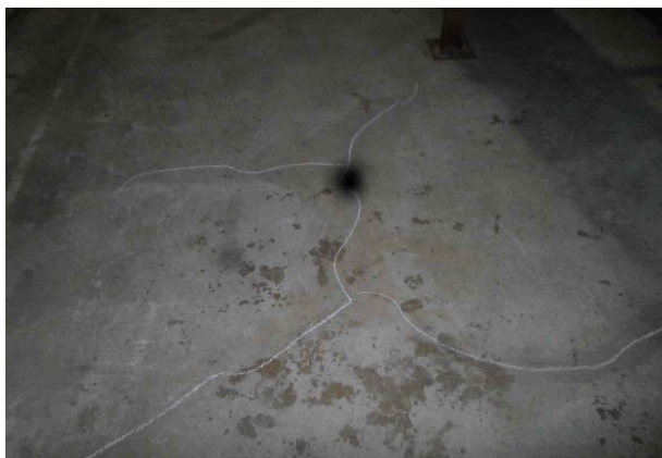
사진번호 091 위치 바닥 내 용 균열 (cw=0.5mm, L=4.5m)
