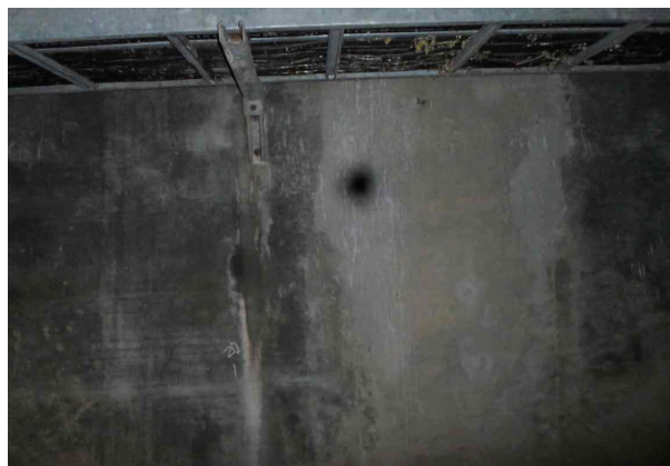
사진번호 094 위치 좌측 벽체 내 용 파손 (A=0.1m×2.0m)
