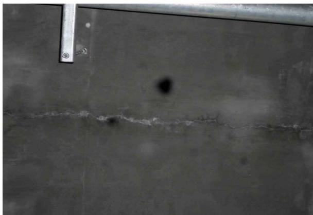
사진번호 093 위치 좌측 벽체 내 용 균열, 백태 (L=1.0m)
