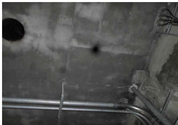
사진번호 092 위치 천장 내 용 균열, 누수흔적 (A=0.1m×3.0m)
